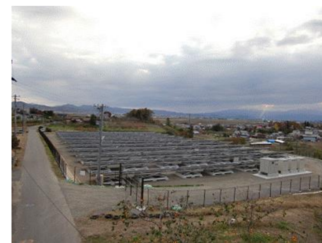
太陽光発電所(変電設備)
